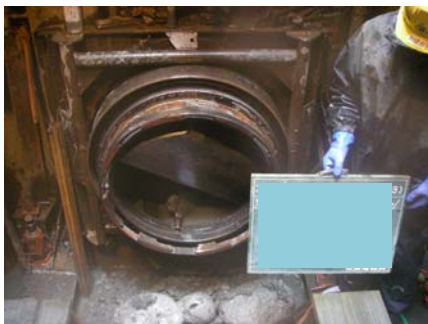
写真一 2 回収した刃先と鋼矢板
