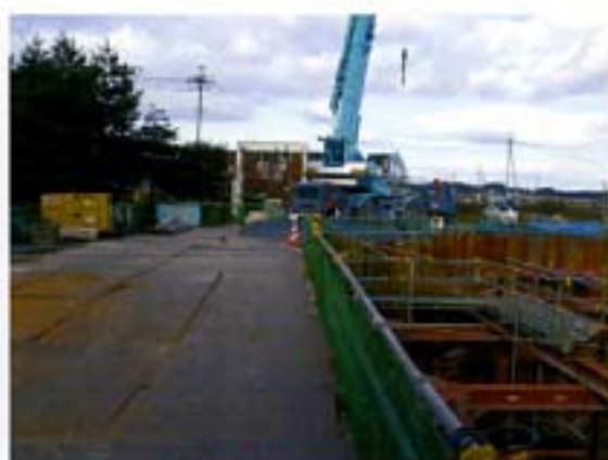
写真-2 現地状況写真 (向側の門型クレーン下部が到達MP)
